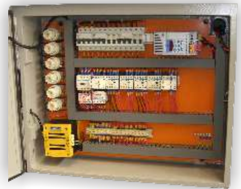
Painel elétrico com grau de proteção IP55
