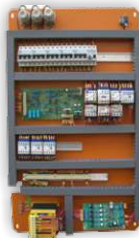
Painel elétrico com grau de proteção IP55
