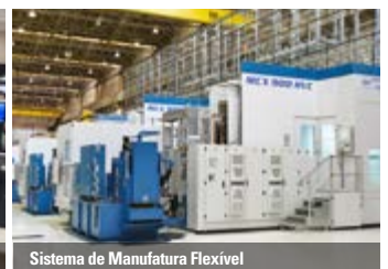
Sistema de Manufatura Flexível
