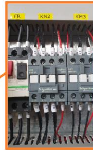
CONTADORES E DISJUNTORES SCHEINDER
